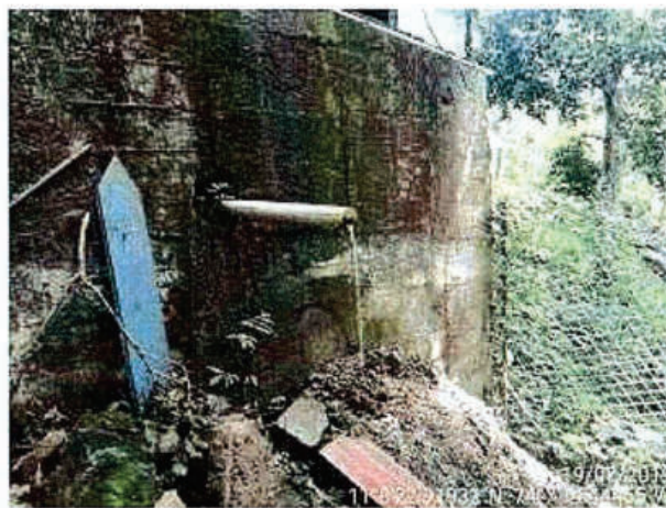
Fotografía N°13. Vertimiento de aguas grises al suelo.
