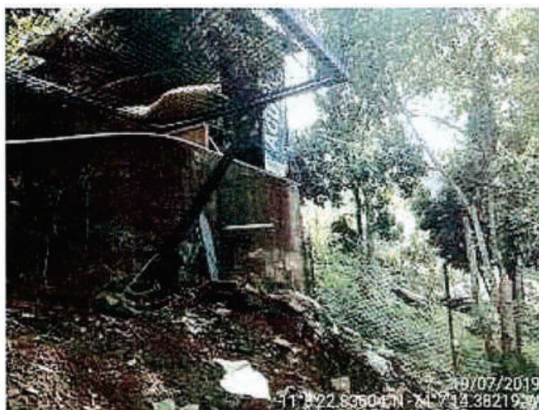
Fotografía N°12. Vertimiento de aguas grises al suelo.
