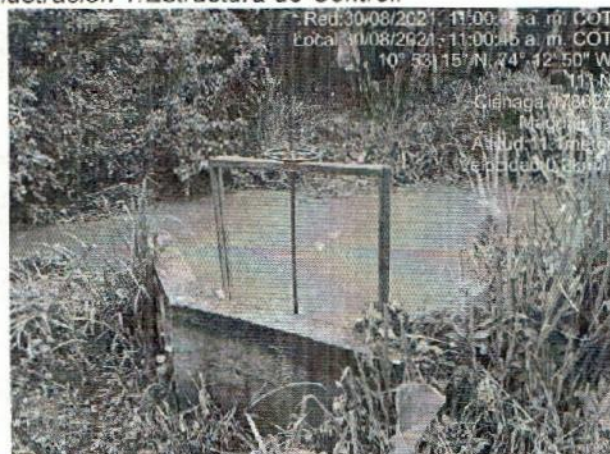
Ilustración 1. Estructura de Control.
