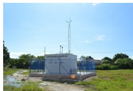
Figura 39 Estación de monitoreo de la Calidad del Aire
