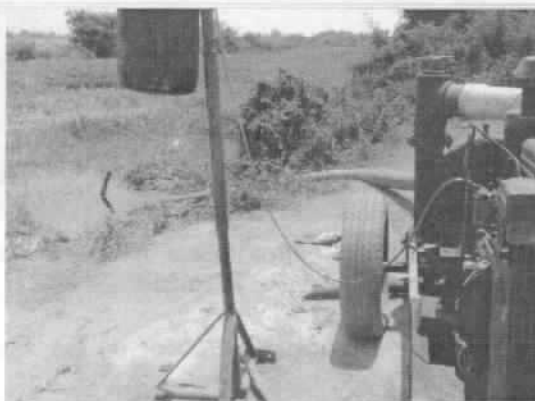
Foto1. Equipo de bombeo emplazado en la coordenada 74°34'24.24\"O 10°38'51.19\"N captando agua del caño Condazo.
