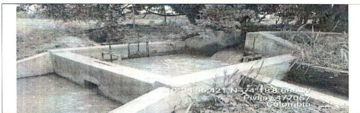
Figura N°3. Estructura de repartición de caudales “El Cuadro”
