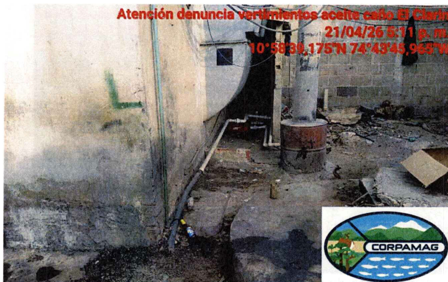
Foto 13. Evidencia de presunta captación de agua (Según manifestó la administradora, esta captación corresponde al hotel Brisas Antioqueñas)
