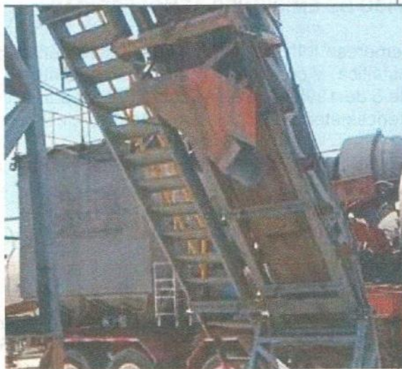
Banda transportadora y filtro de mangas
