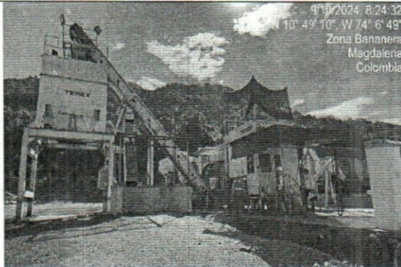
Fotografía 1: Planta de mezcla de asfalto en caliente.
