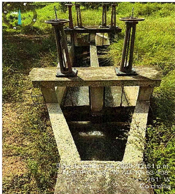
Ilustración 4 Estructura de llegada de llegada del agua residual desde la EBAR.
